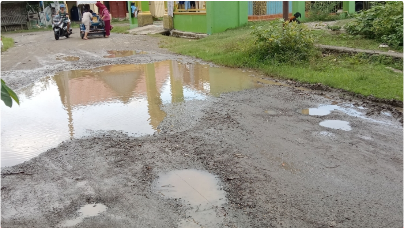
Jalan poros perumahan Citramas/Pallateang Kelurahan Biraeng rusak berat
